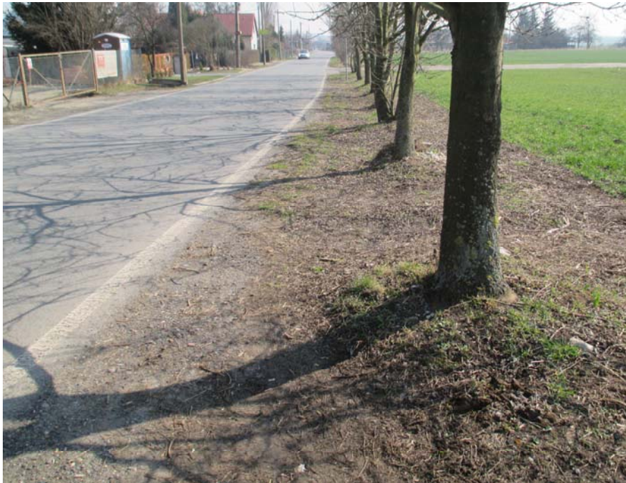
Obr. 1 – ul. Hlavní – chybějící odvodňovací zařízení
