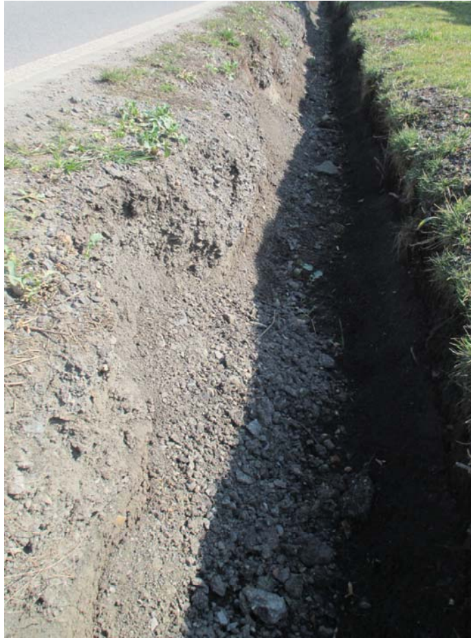
Obr. 9 – nevhodně provedená prohrábka příkopu – ul. Hlavní
