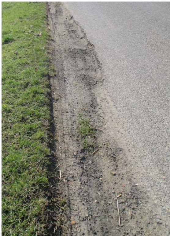
Obr. 2 – krajnice komunikace narušena vlivem proudící vody
